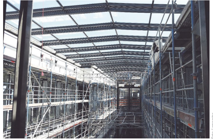
Bild 7 Innenansicht Passage nach Rückbau Raumgerüst Inside view of passage after removal of scaffold
